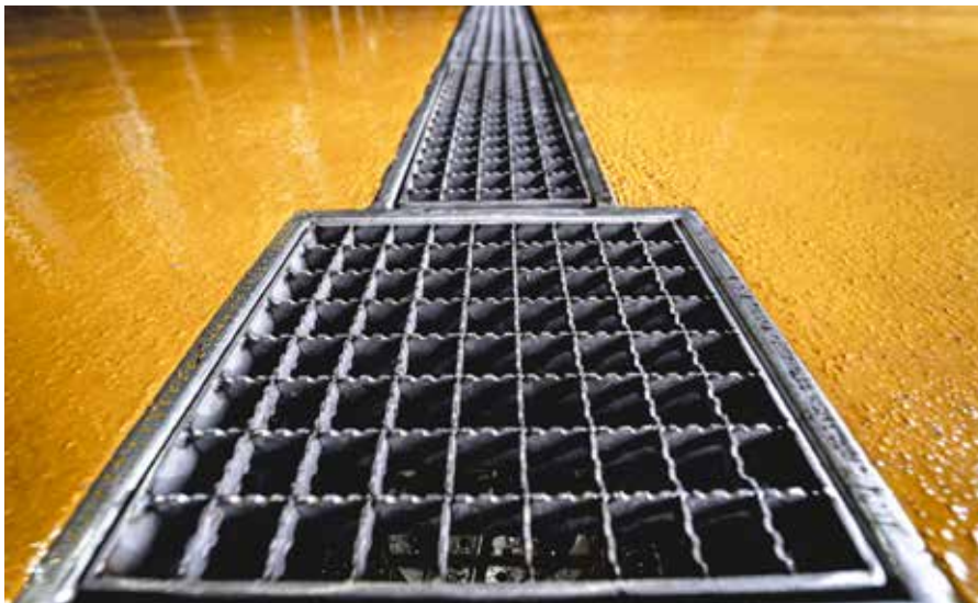
Bodenablauf aus Stahl in einer Brauerei
